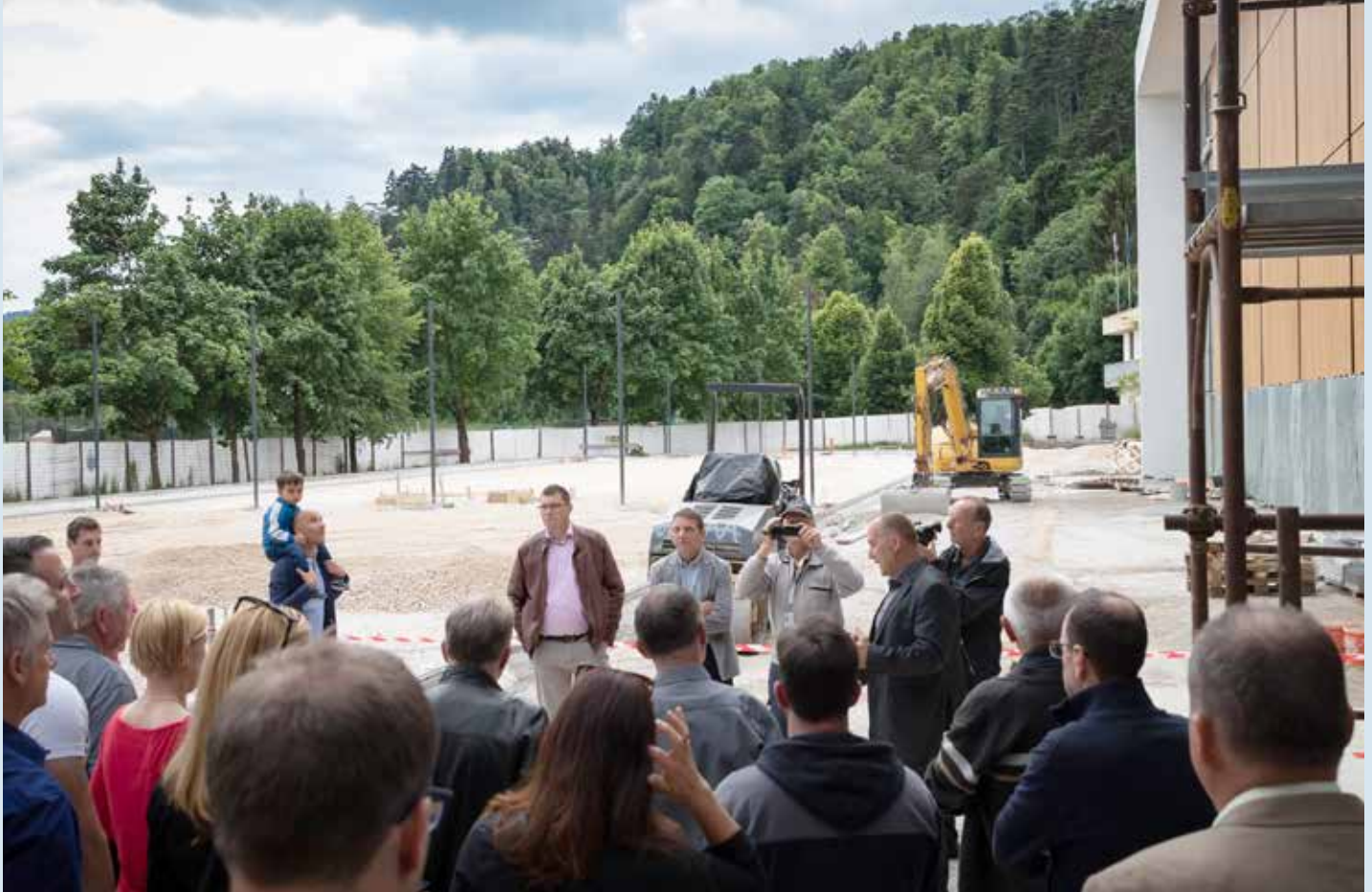
Gradnja zunanjih igrišč pri južnem delu športne dvorane, ki bodo opremljena z različnimi elementi in tako omogočala uporabo za številne športne discipline, poteka v skladu z načrti. Vidijo se že roketno in košarkarsko igrišče, atletska steza in zunanja povezovalna pot med šolo oziroma parkom in dvorano.
